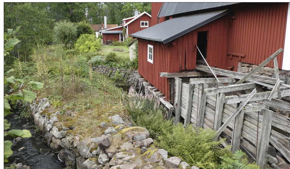
Figur 10. En delvis förfallen intagskanal till turbinhuset i Lagmanskvärn. Foto Alf Ericsson.
